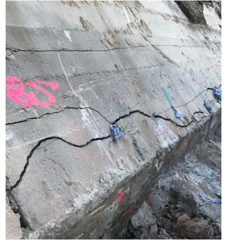
Betonmuur langs de boorgatenrij gecontroleerd gescheurd
