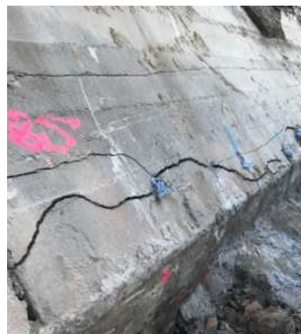
Betonsmur revnet kontrolleret langs rækken af borehuller
