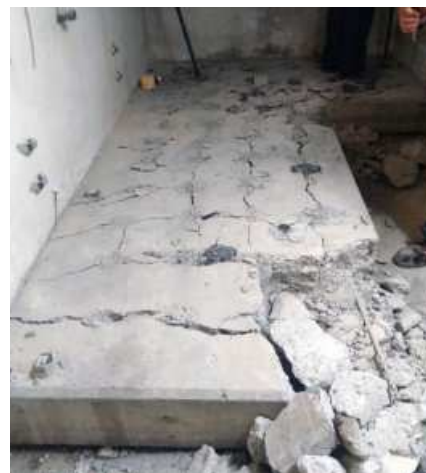
Betonfundament nedbrudt indendørs
