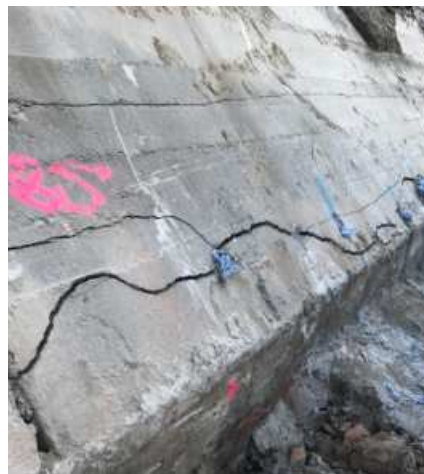
Betongmur kontrollert sprukket langs borrekken
