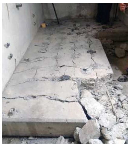
Бетонски темељ срушен у унутрашњем простору
