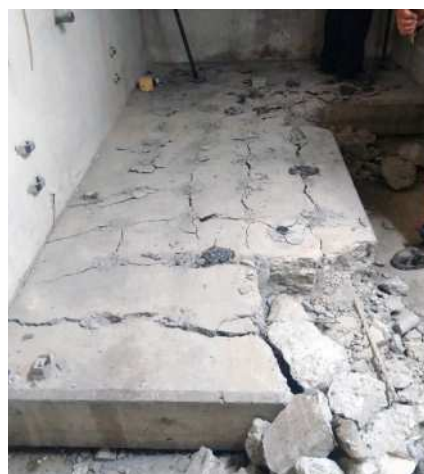
Betonski temelj srušen u unutrašnjem prostoru
